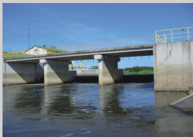
666,4 Niebezpieczny jaz w Zakrzówku
