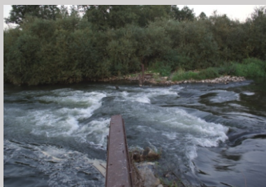
539,7 Zniszczony próg wodny w Tyczyń
